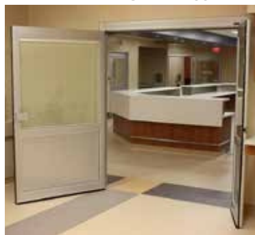
GT2300 ICU Door
