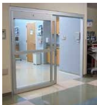
GT2125 ICU Door
